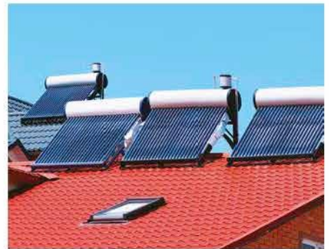
Figura 22.6 A través de un sistema de tubos colectores se aprovecha la energía luminosa del Sol para calentar agua.
